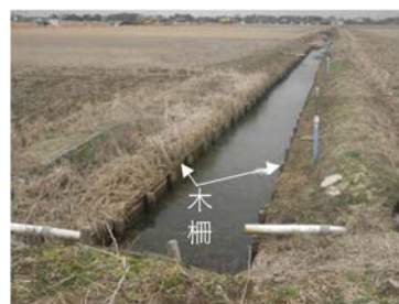
Fig.1 木柵による整備された水路法面
