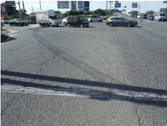
写真 1 令和 2 年 10 月の路面状況
