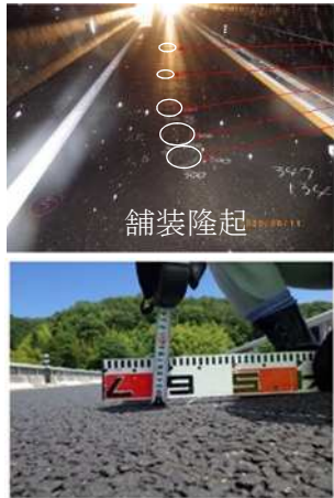
写真-1 舗装隆起の発生状況
