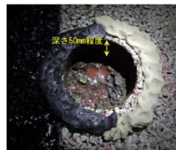
写真-4 色水流出状況
