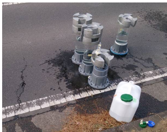
図-2 簡易な透水円筒によるひび割れ部からの浸透水の試験状況の例
