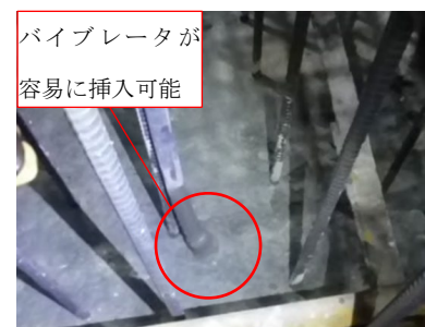
写真-1 19 時間後の超遅延コンクリート表面の状態
