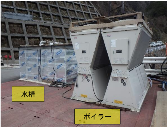
写真 1 ボイラー設備
