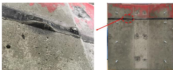
写真.3 ケース③・水膨張ゴムの剥離状況
