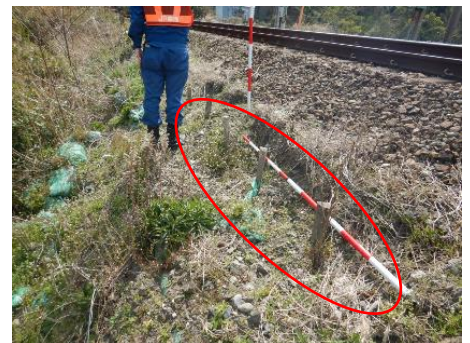
図－1 獣害を受けている盛土
