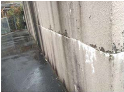
写真 4.3 コールドジョイント
