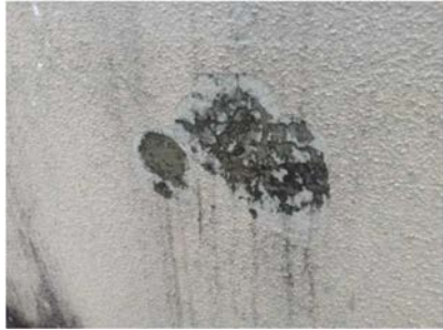
写真 4.4 塗装の剥がれ
