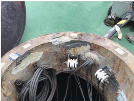
写真 4.5 点検口の腐食状況
