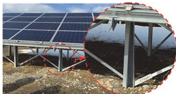
図-1 ソーラーパネル架台の変形
