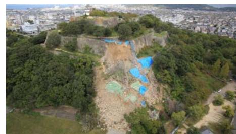
写真-1 石垣崩落状況
