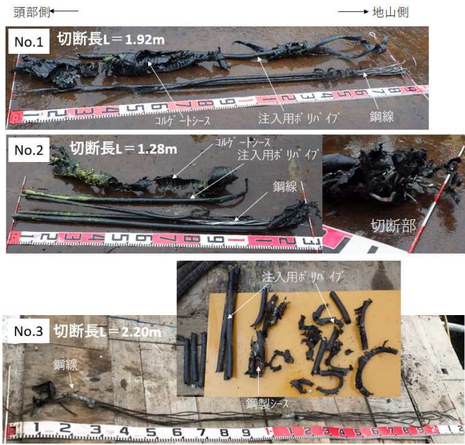
写真-2 切断・回収されたアンカー写真
