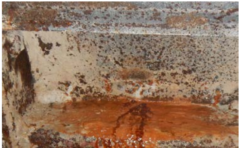
図-4 リング番号 131 におけるスキンプレート孔食
