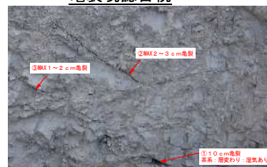
亀裂現認目視
