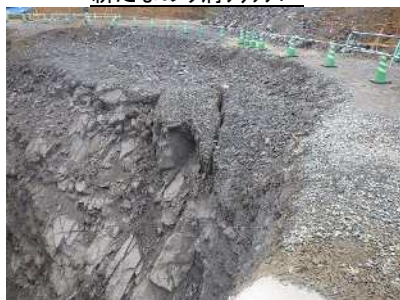
新たなのり肩クラック:
