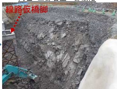
同左 上部岩盤一部崩落
