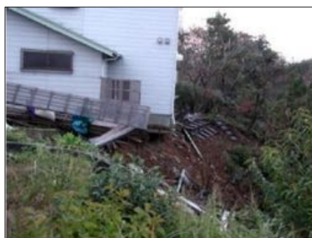
写真. 7 民家被災状況(長岡技術大学)
