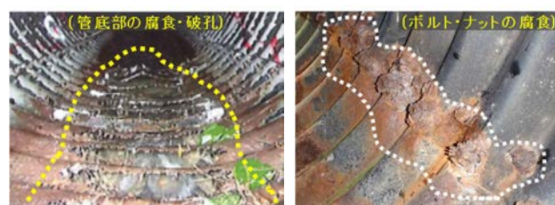
図-5 山地部盛土内 CP の管部材腐食状況
