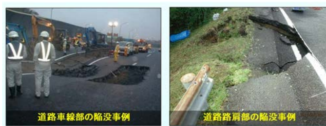
図-2 たわみ性CPの損傷による道路への影響事例
