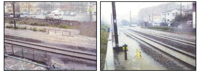
写真1 台風 23 号による線路冠水状況
