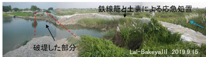
図-3 2019 年 7 月洪水で破堤した Lal-Bakeya 川左岸堤防
