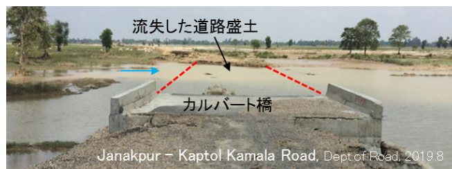
図-4 氾濫水が越流して流失した道路盛土
