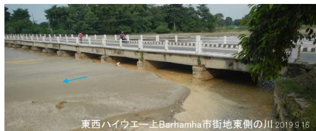
図-2 河床が上昇して桁下高が低くなっている橋梁
