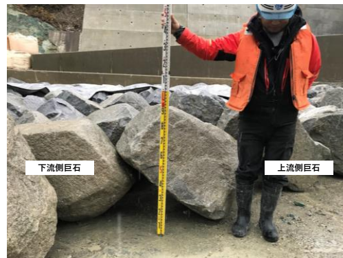
写真-1 据付け形状
