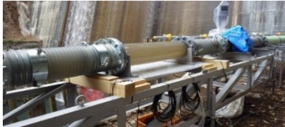
図-3 流量・土砂濃度計測装置据付状況
