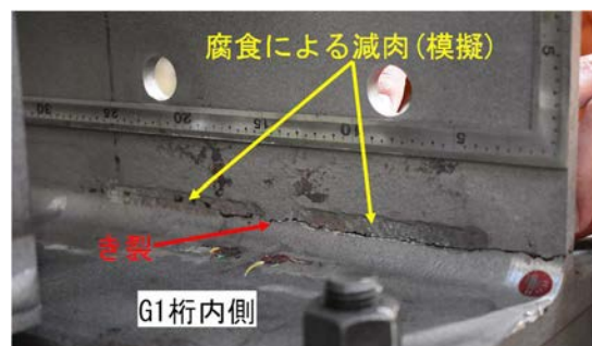
図7 発生したき裂 (G1 桁内側)
