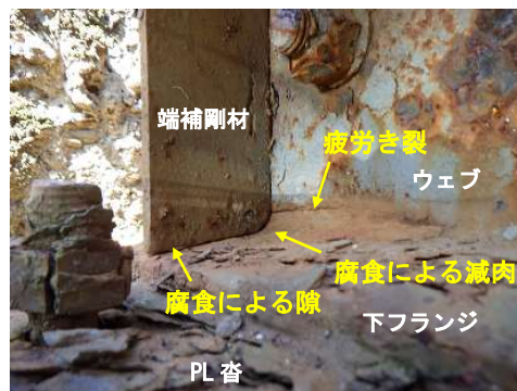
図 1 支点部近傍の疲労き裂と腐食状況
