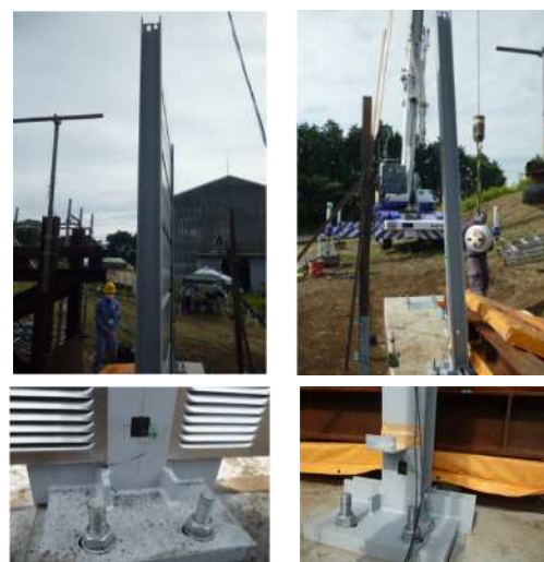
(1) 支柱3本 (2) 支柱1本 写真-1 衝突後の状況
