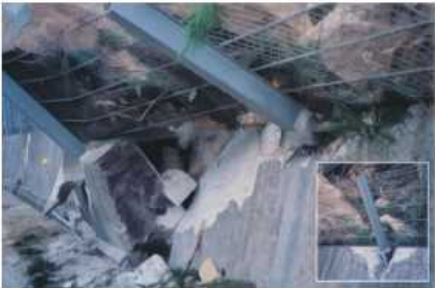
写真-1 支柱基部の損傷例
