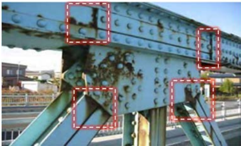
図-1 連結板際部における母板腐食の事例 3)
