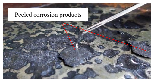
図-6 腐食生成物剥離の様子
