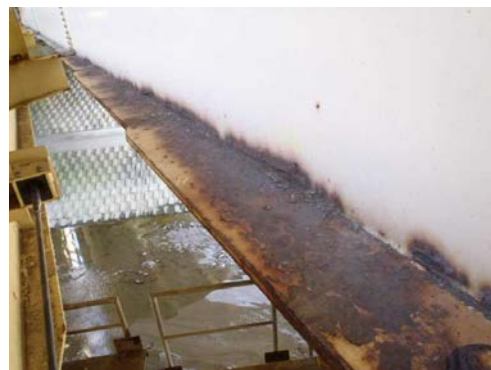
写真-1 下フランジ部の腐食事例
