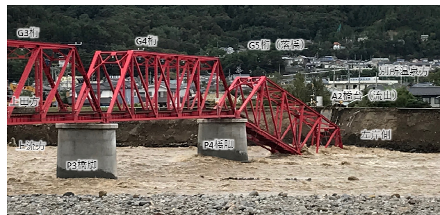
【図-2 千曲川橋梁被災状況】
