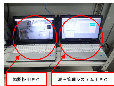
写真-2 中央監視室内PC
