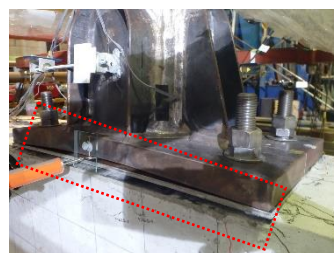
写真-1 ベースプレートの変形 (左) とアンカーボルトの伸び (右)
