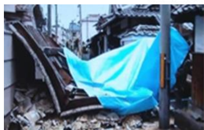
大阪府北部の地震(2018,M6.1) 図12 屋根の反転(浄教寺,茨木市)
