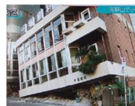
熊本地震 図13 層間破壊例(1)
