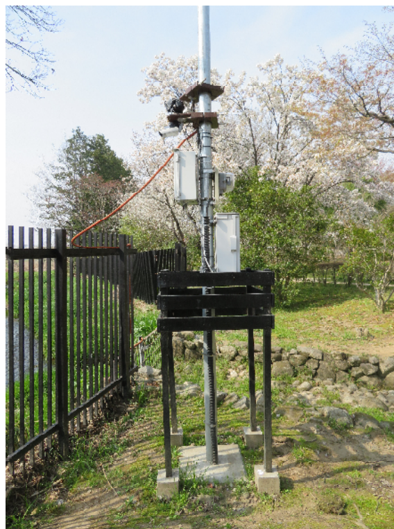
図-2 沢渡川の内水氾濫監視システム外観
