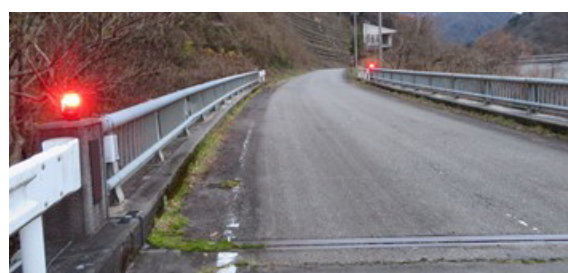
写真-3 動作確認時の LED 表示灯の点灯状況
