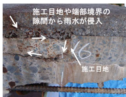
写真-3 水平ひび割れへの雨水等進入状況
