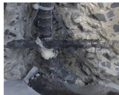
写真-2 コの字鉄筋の変形状況
