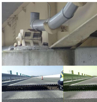
写真－1 支承部損傷による段差状況
