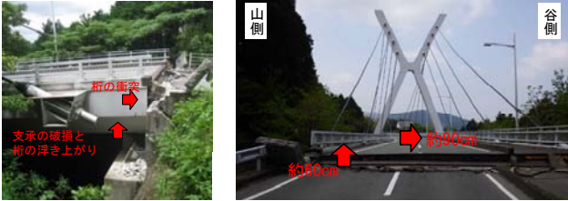
図-1 桁端部の浮き上がりと桁全体の移動
