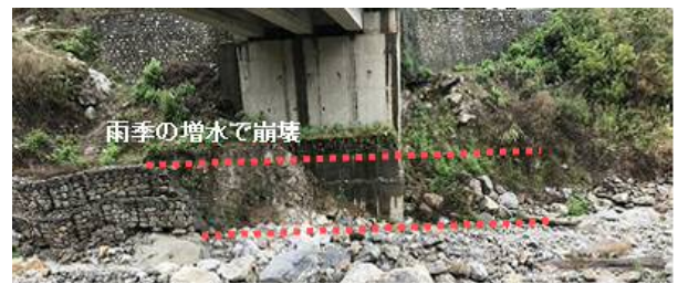
写真3 蛇籠の崩壊例
