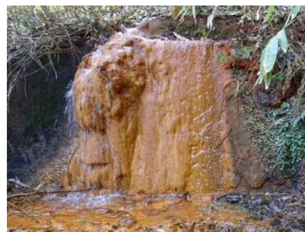
図-2 盛土法尻部の鍾乳洞状態の化成品
