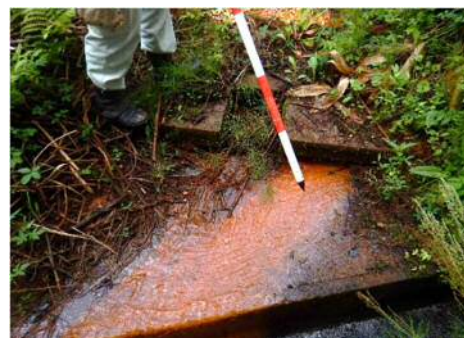
図-4 高速道路外盛土部からの湧水
