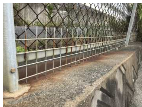
写真-1 立入防止柵の下部閉塞
