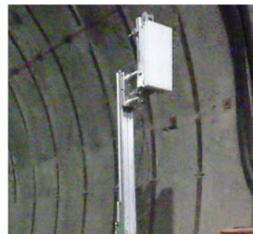
写真-1 トンネル内に設置した可搬型 5G 設備「おでかけ 5G」
