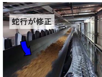
写真-5 負荷試運転状況
