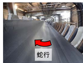
写真-4 無負荷試運転状況
