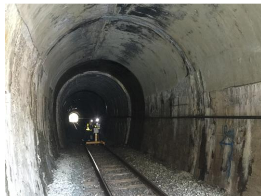
写真-1 コンクリートの経年劣化
