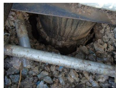
写真－2 路盤陥没状況
