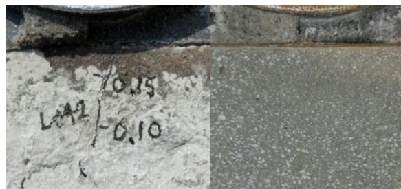
図-5 モルタル表面状態 (左: 掘削前, 右: 2mm 掘削後)
