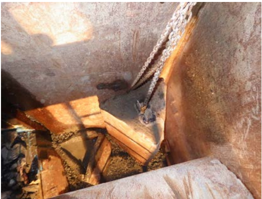
写真-3 攪拌翼脱落状況
