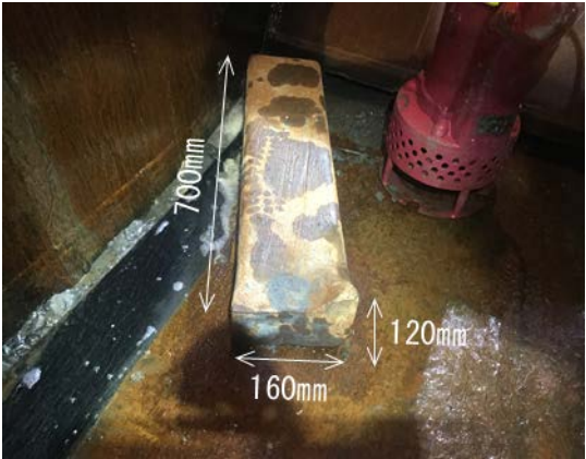
写真-2 損傷原因物の鉄塊
