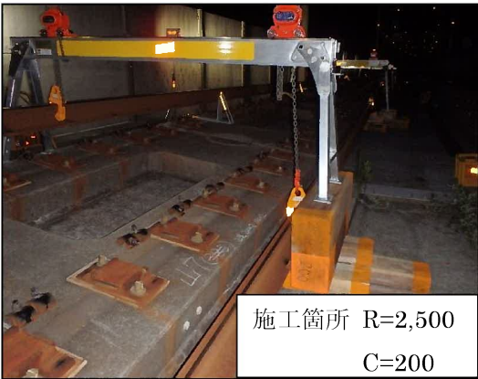
写真-1 レール開き・扛上状況
