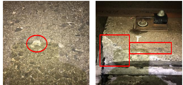
図-2 目視調査での不良状態
