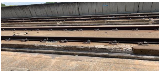
図-1 スラブ本体の損傷状態
