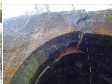
写真-2 坑口被害状況
