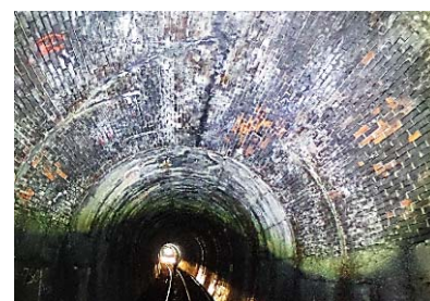
写真-3 覆工剥落
