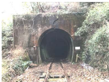
写真-1 坑門被害状況
