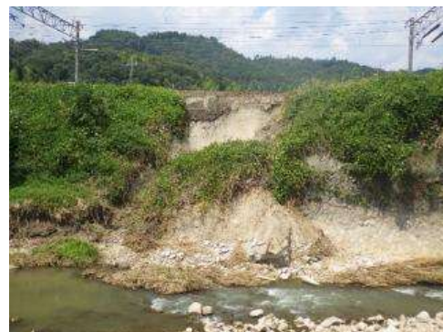
写真-1 被災状況
