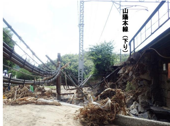
写真-1 被災状況（橋梁終点方橋台背面）
